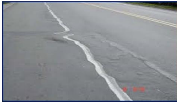
Figura 7: Falla tipo Corrugación
