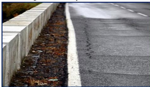
Figura 9: Falla tipo Fisura de borde
