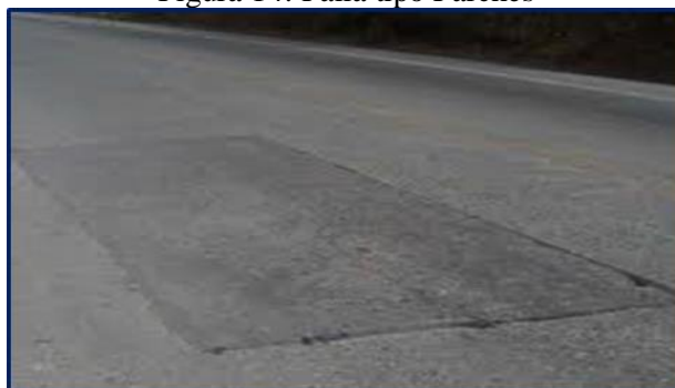
Figura 14: Falla tipo Parches
