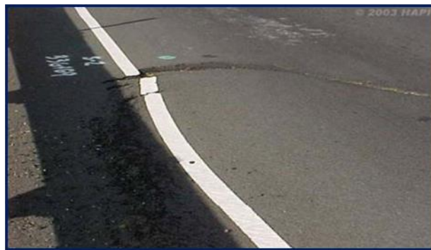
Figura 18: Falla tipo Desplazamiento
