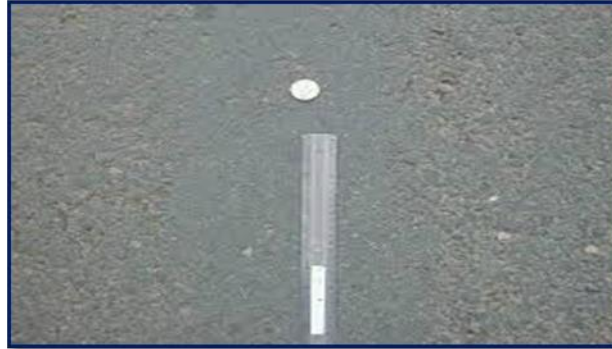
Figura 15: Falla tipo Agregado pulido
