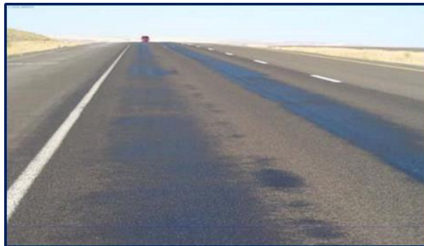
Figura 3: Falla tipo Exudación
