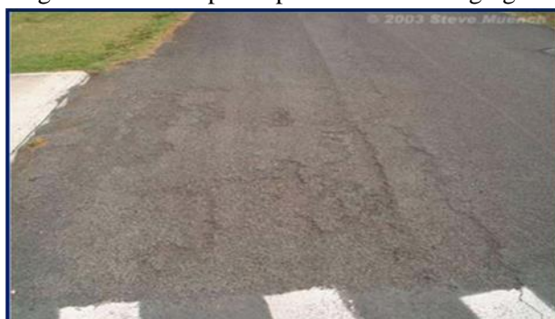
Figura 21: Falla tipo desprendimiento de agregados
