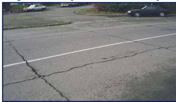
Figura 10: Falla tipo Fisura de reflexión de junta
