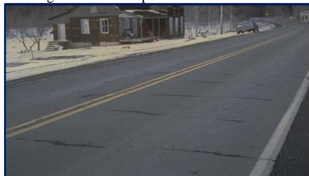
Figura 13: Falla tipo Fisuras transversales
