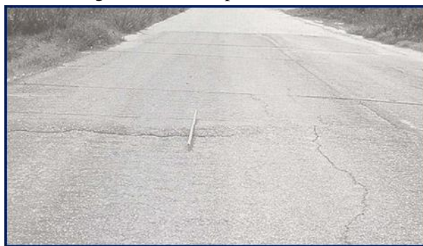
Figura 20: Falla tipo Hinchamiento
