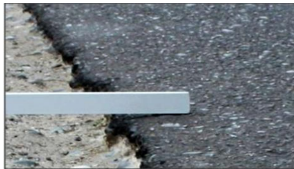
Figura 11: Falla tipo Desnivel carril –berma
