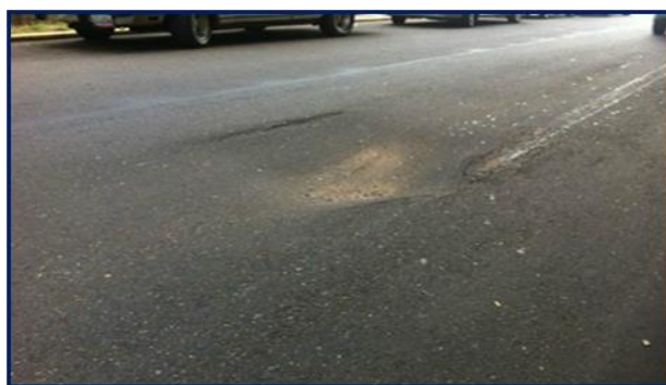
Figura 6: Falla tipo Hundimiento
