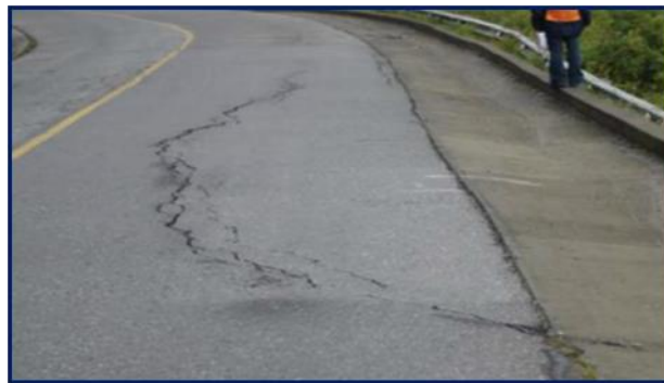
Figura 19: Falla tipo Fisura Parabólica
