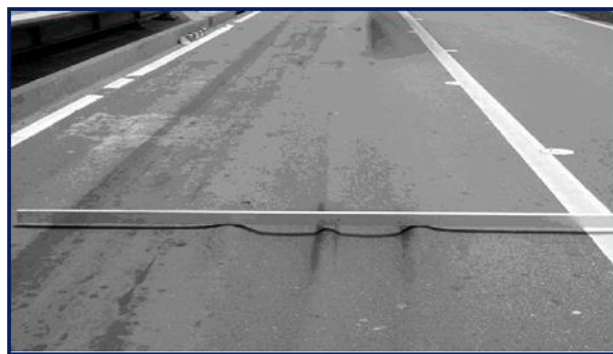
Figura 17: Falla tipo Ahuellamiento
