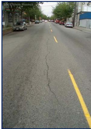
Figura 12: Falla tipo Fisuras longitudinales
