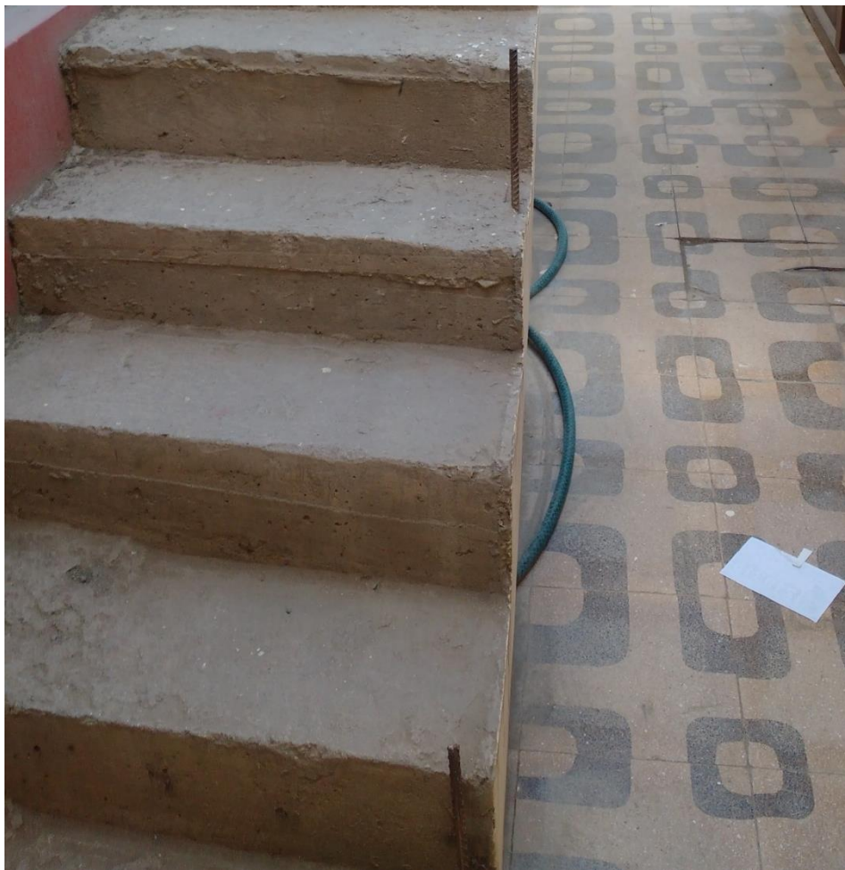
Ilustración13: Escalera externa falso piso, sin barandas y con fierros expuestos
