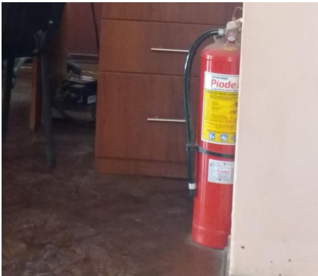
Ilustración 11: Extintor en los ambientes del CEM
