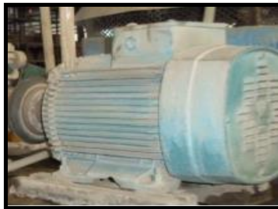
Figura 70: Bomba de vacío.
