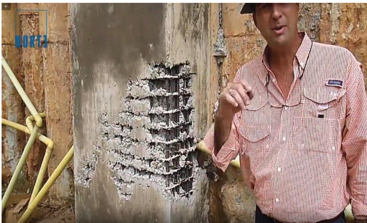
Fotografía 1.- Foto de Cangrejera (imperfecciones), presentada en la esquina de la columna.
