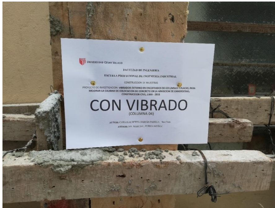
Fotografía 28.- Datos de la columna indicando que fue vibrada Origen: Propio
