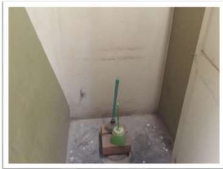
Figura 80. S.S.H.H. en condiciones deplorables
