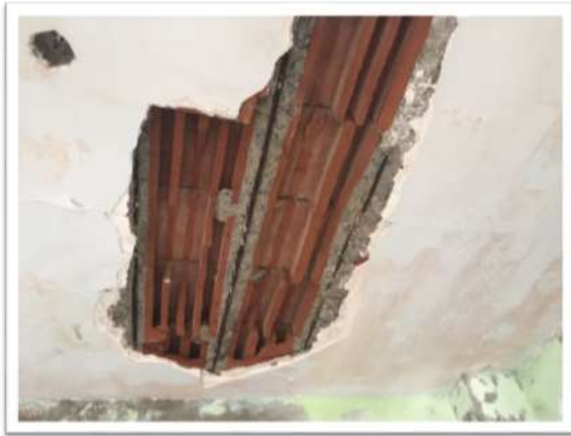
Figura 78. Taller de carpintería con techo en riesgo de colapso
