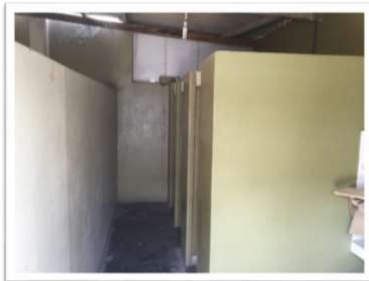
Figura 81. S.S.H.H. con falta de condiciones arquitectónicas
