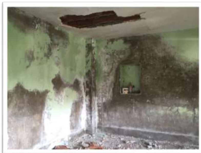
Figura 77. Taller de carpintería Presenta daños en los techos
