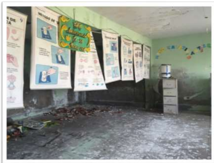
Figura 79. Taller de manualidades con Techo en riesgo de colapso
