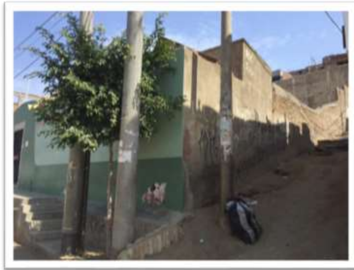
Figura 84. Exteriores del Cetpro pésimas condiciones
