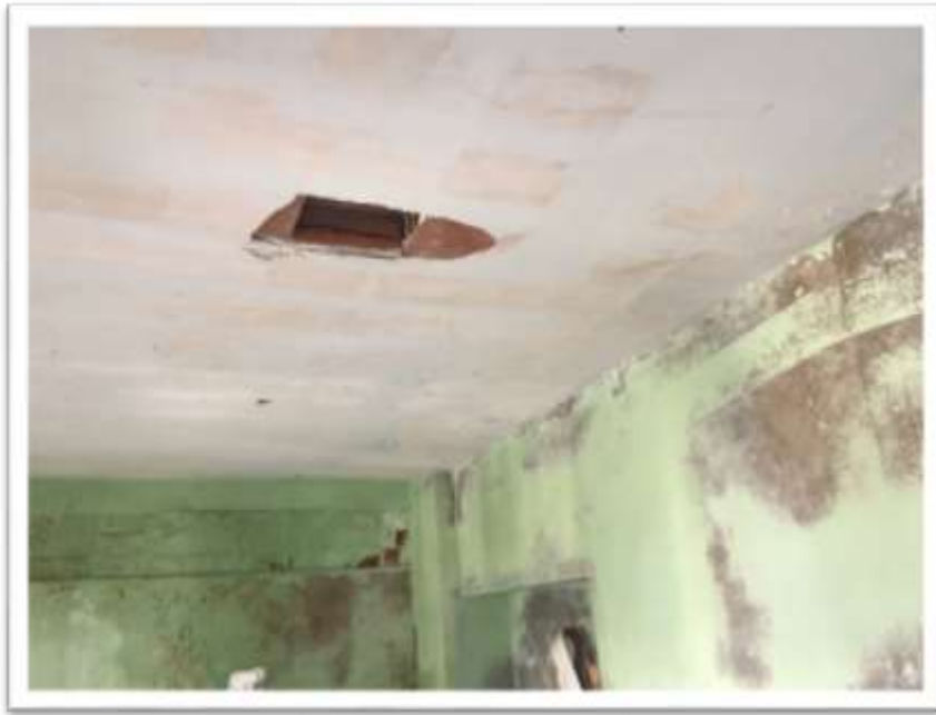
Figura 76. Taller de carpintería Presenta daños estructurales
