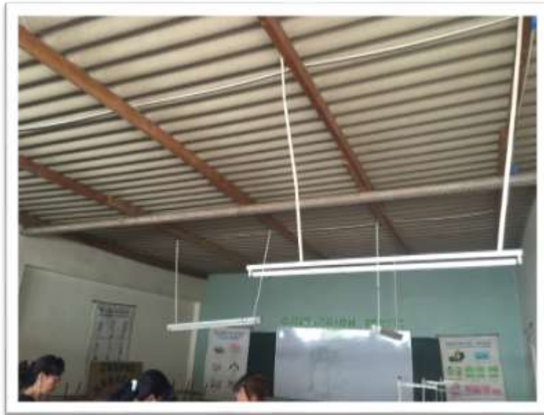
Figura 82. Taller de costuras con techo de material débil no apto para aulas Fuente: Elaboración Propia.
