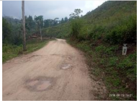
Imagen 11: Estado de la carretera Km. 01.
