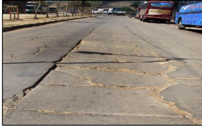
Figura 01: Fallas de pavimento flexible.
