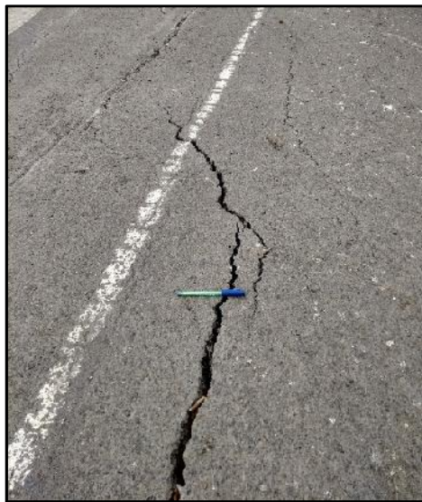
Foto 4. Grieta de borde de alta severidad
