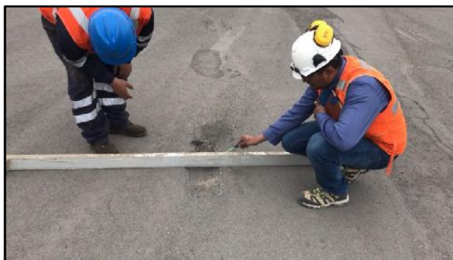
Foto8. Bache de severidad media
