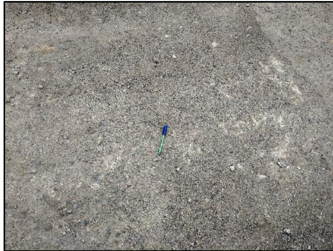
Foto3. Desintegración de media severidad.
