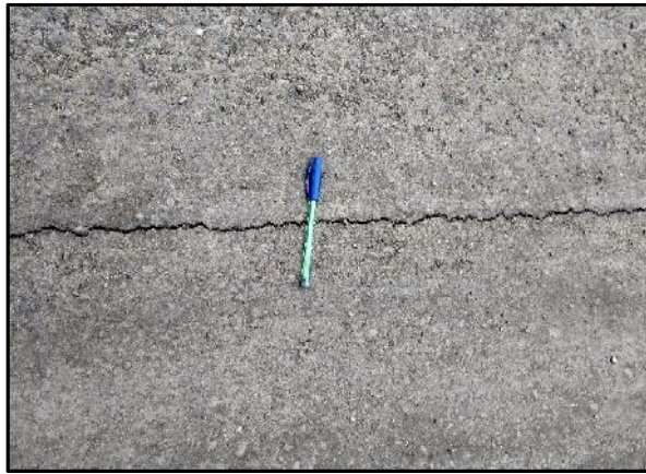
Foto 6. Fisura transversal de alta severidad.
