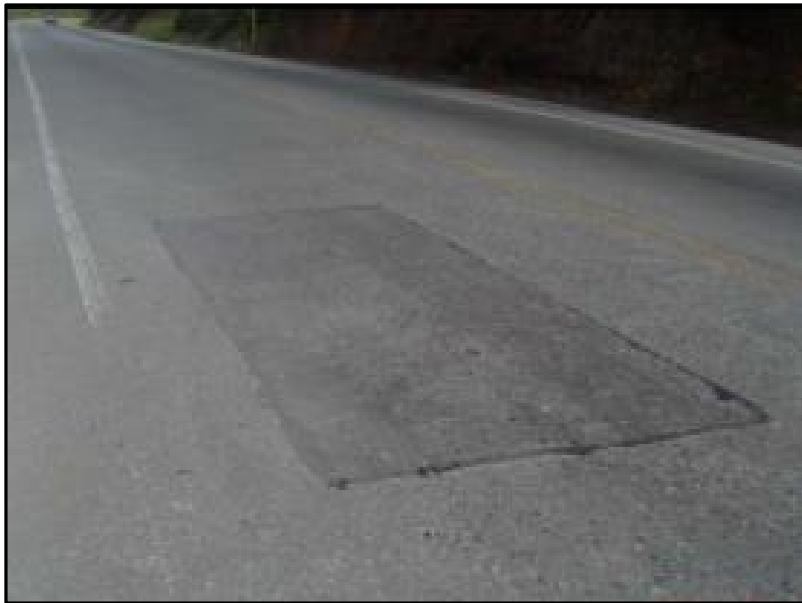
Foto 5. Parche deteriorado de media severidad presenta irregularidad y fisuras en los bordes
