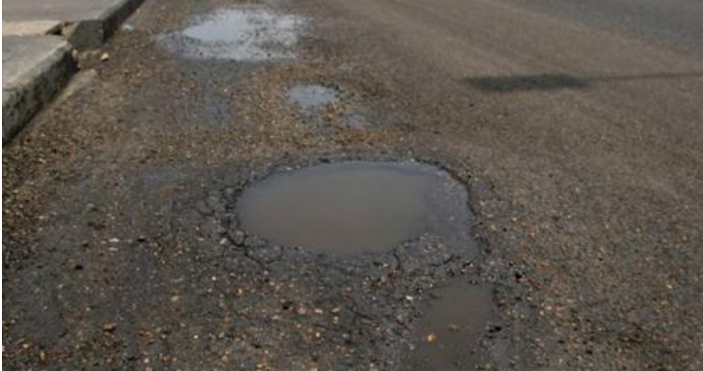
Ilustración 11: carpeta asfáltica dañado por el agua.
