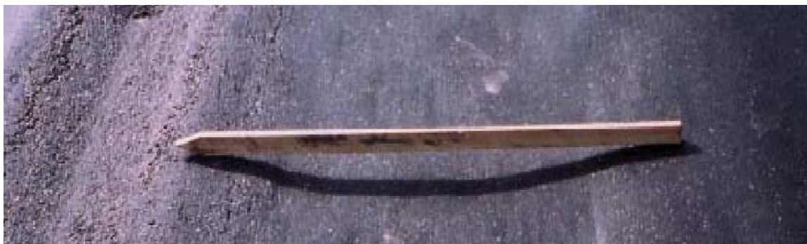
Figura 06. Ahuellamiento o deformación permanente (Minaya y Ordoñez, 2013, p. 9).
