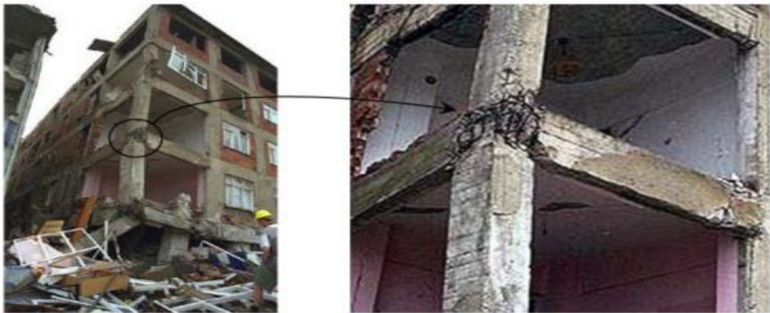
Figura 1: Fallas en una estructura porticada.
