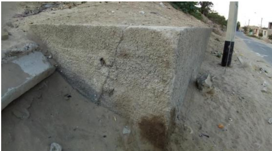
Figura 2: Muro de contención con agrietamientos- AA.HH. Bellavista, Independencia
