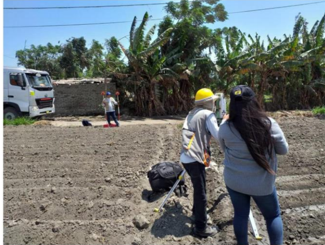
IMAGEN 09: Toma de puntos de áreas verdes red vial vecinal con la estación total.
