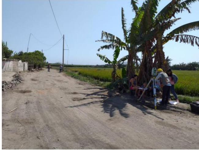
IMAGEN 07: Toma de puntos de estación de la red vial vecinal con la estación total.
