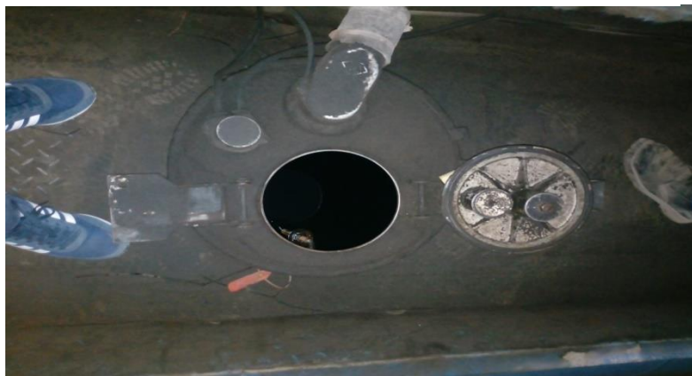
Figura 18. Falta de limpieza a la cisterna
