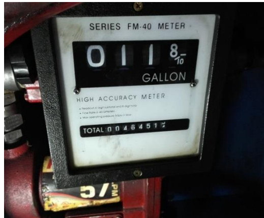
Figura 19. Medidor de combustible
