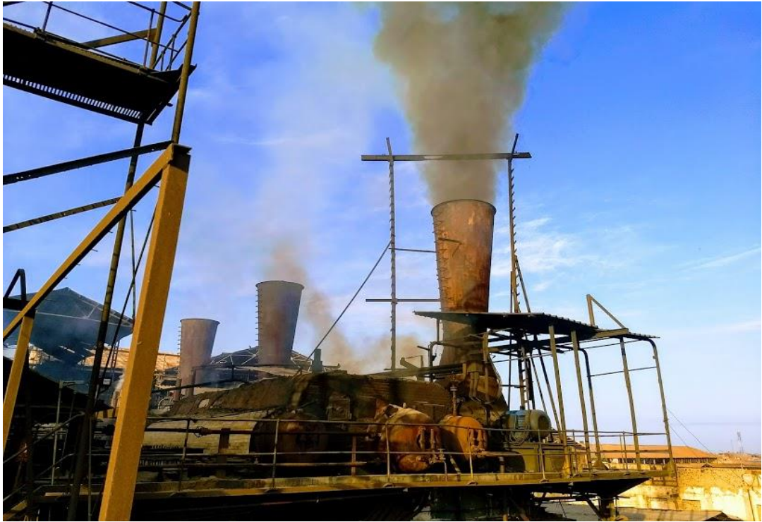
Foto. N°1. Parte superior Caldera 06, domos superiores y chimenea.
