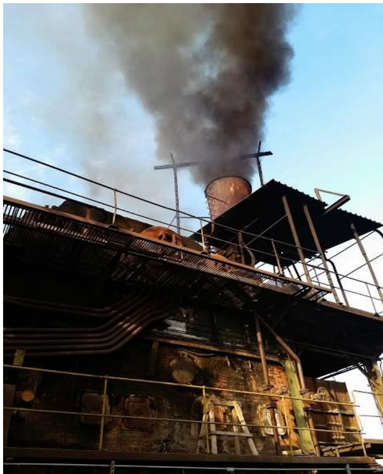
Figura N° 18. Emisiones de la Caldera N 06.
