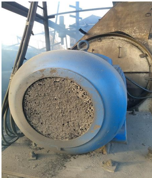
Foto. N°2. Motor Tiro Inducido, afectado por la ceniza.
