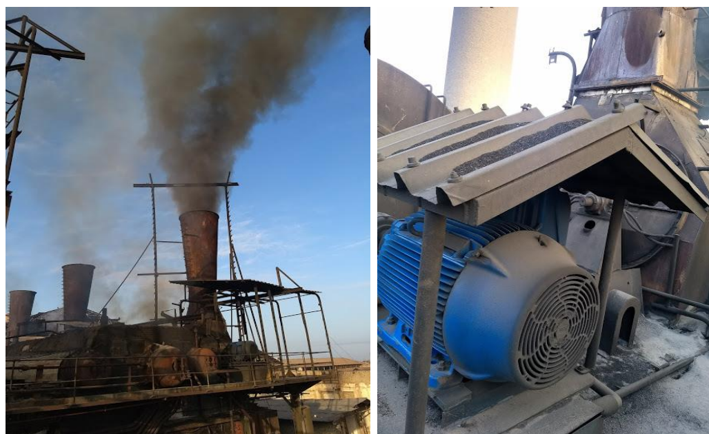
Figura N° 1. Equipos afectados por la emisión de material particulado y ceniza.
