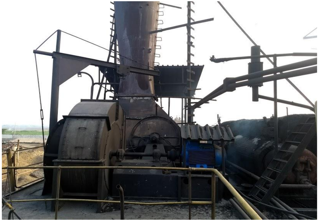
Foto. N°3. Parte superior de Caldera 06, equipos Tiro Inducido y Forzado
