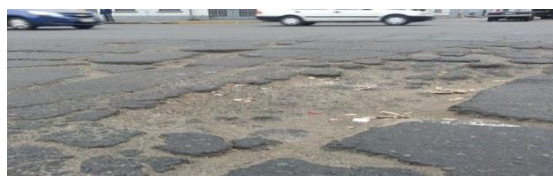
Figura 1 AV. Zona Tacna km 1 Puente Piedra-fallas en los pavimentos (bacheos)
