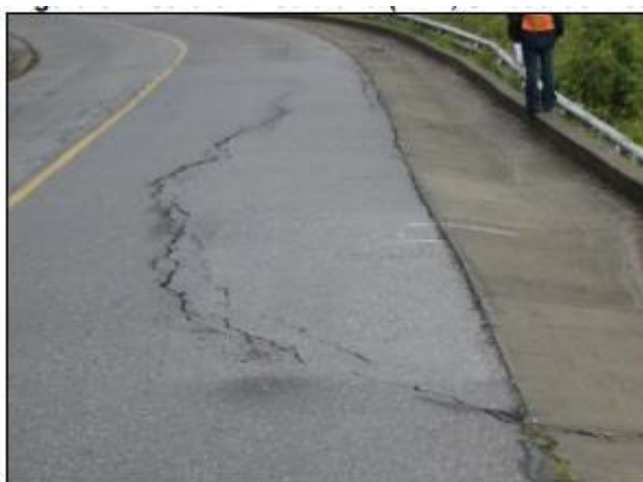
Figura 2: fisuras y grietas en el pavimento flexible
