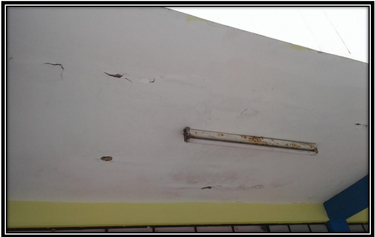
Figura 6: Fisuras en alero de losa aligerada.
