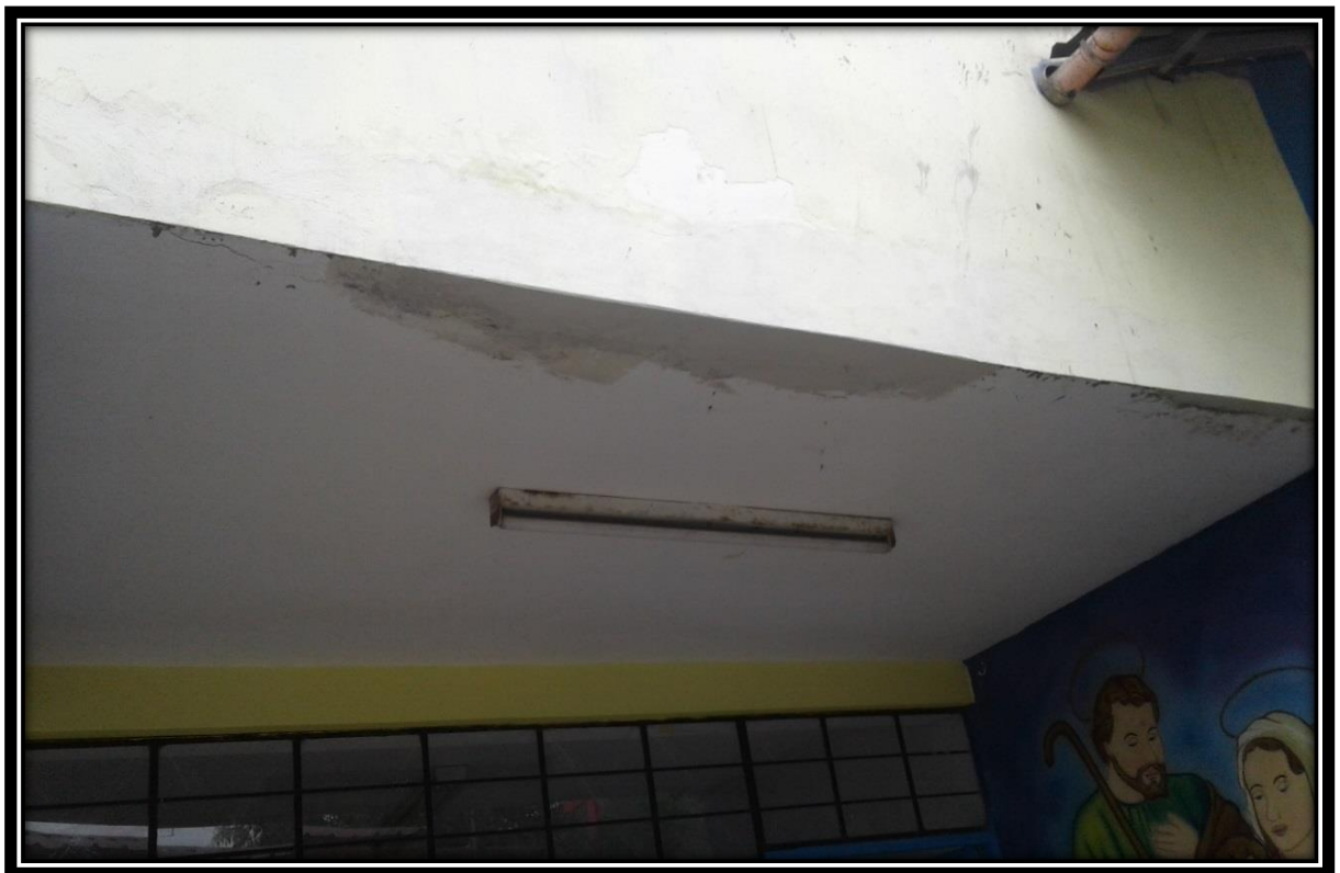
Figura 5: Resane de tarrageo en el alero (patología de fisura).
