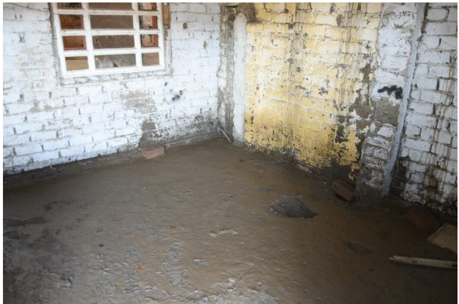
Figura 10: Otra vista de interior de viviendas anegadas
