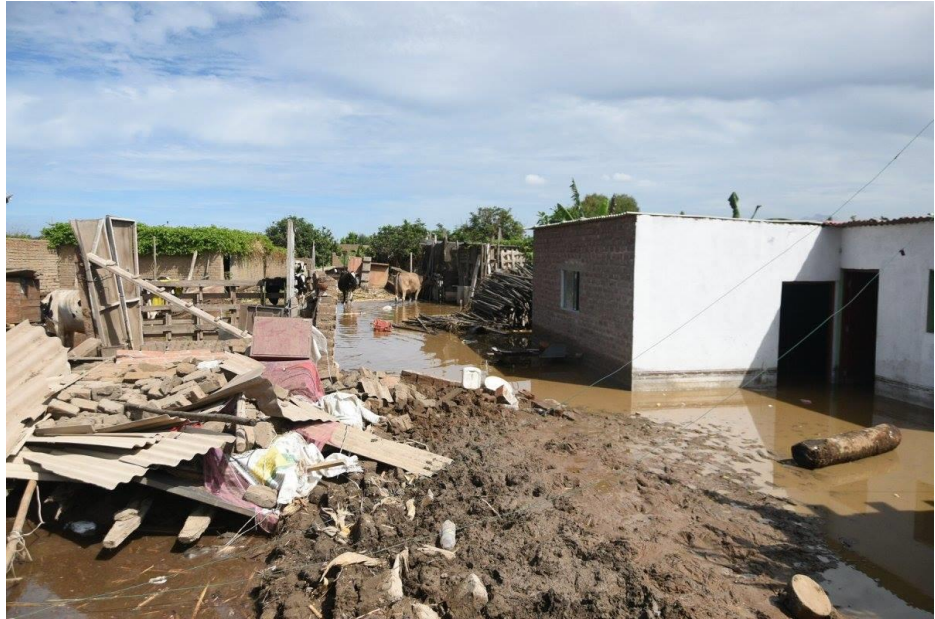
Figura 5: Viviendas de adobe derrumbadas
