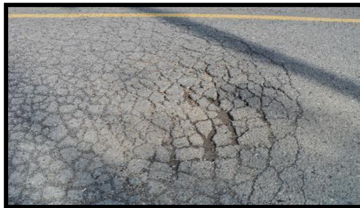
Figura I.4. Agrietamiento por fatiga.
