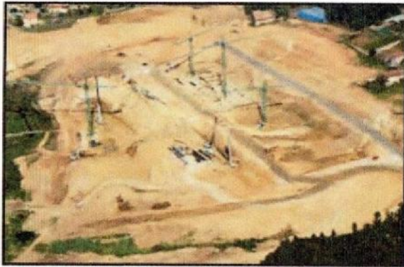
1 Excavación y cimentación mediante un sistema de pilotaje, ejecutando 25.700 metros lineales de pilotes y zapatas.
