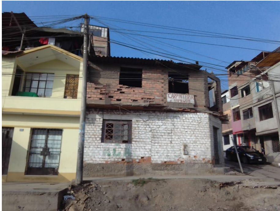
Figura 35: A9.5 - Vivienda en estado crítico (Av. El Trabajo) Fuente: Elaboración Propia
