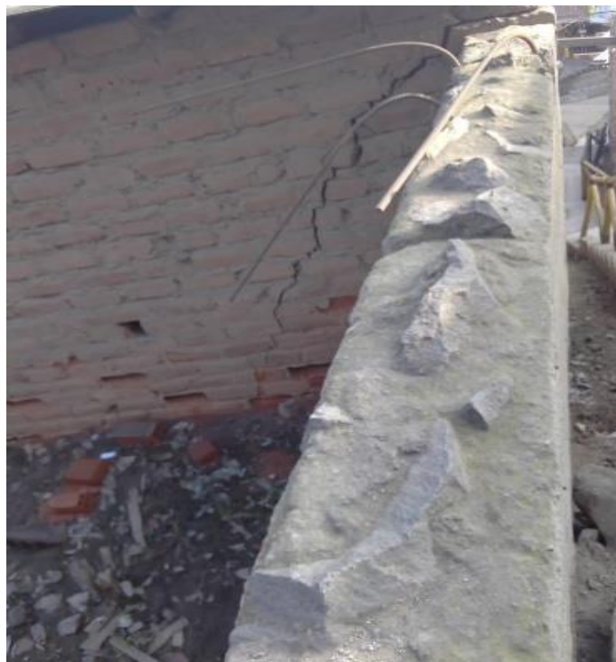
Figura 36: A9.6 - Grieta en un muro de albañilería (Av. El trabajo) Fuente: Elaboración Propia
