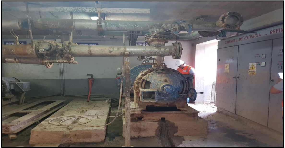
Gráfico 26: Análisis de vibración al motor eléctrico de la bomba T200
