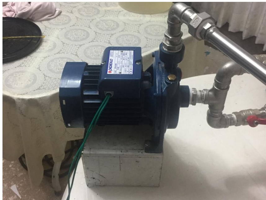
Figura 16: Bomba de agua.
