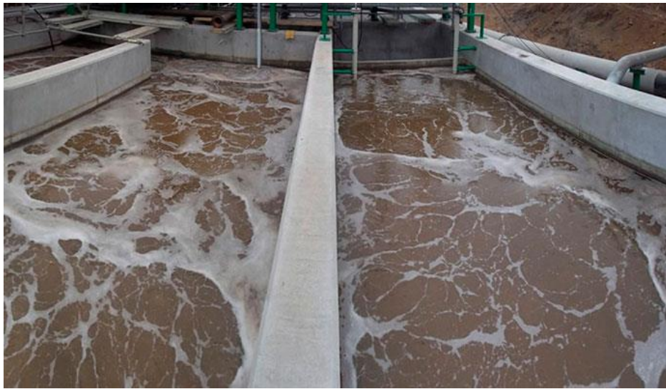
Figura 4: Planta de tratamiento del agua residual de la Refinería.
