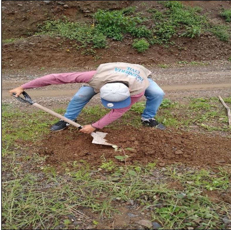
FOTO 10: SE OBSERVA UNA VISTA PANORÁMICA DE LA EXCAVACION DE LA CALICATA. C-03
