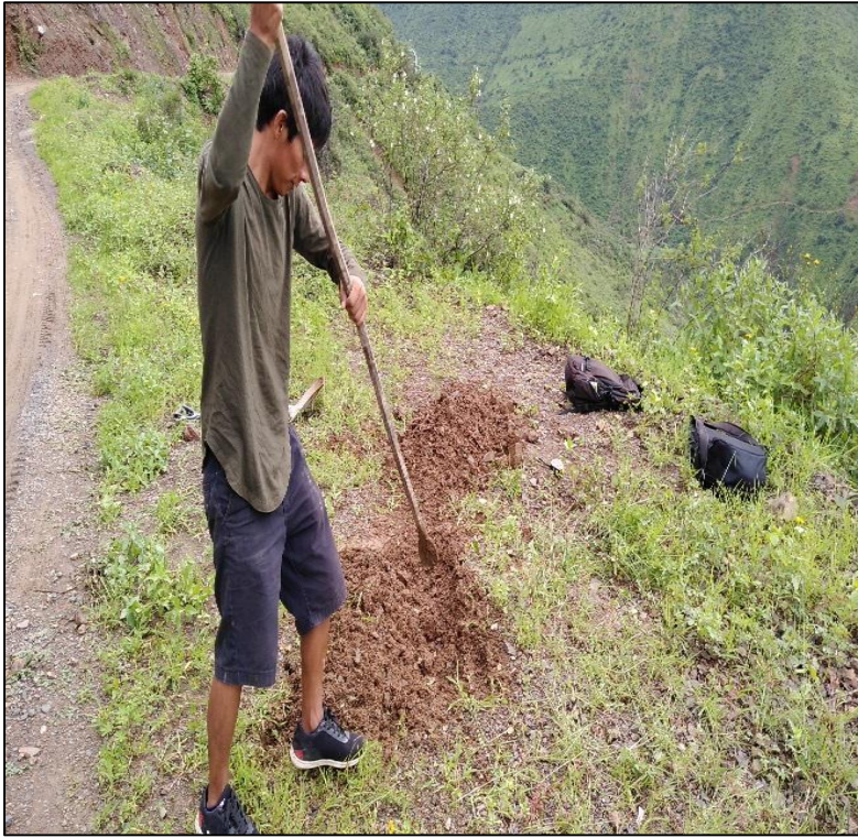
FOTO 14: SE OBSERVA UNA VISTA PANORÁMICA DE LA EXCAVACION DE LA CALICATA. C-05
