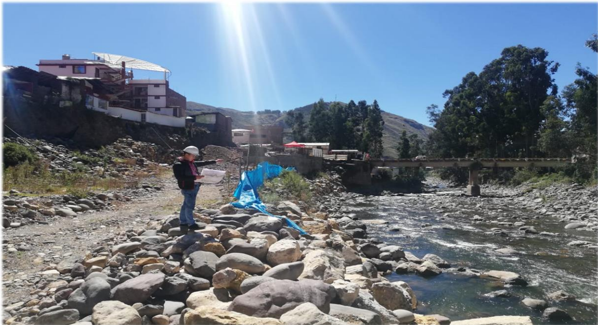
Figura 2. Zona vulnerable expuesta a desbordamiento por el río Sicra.
