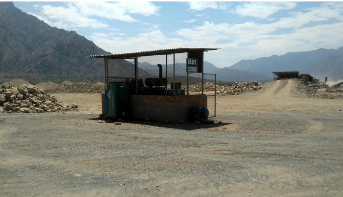
Grupo electrógeno en el sector Planta Chancadora en la cantera Pátapo La Victoria S.A.
