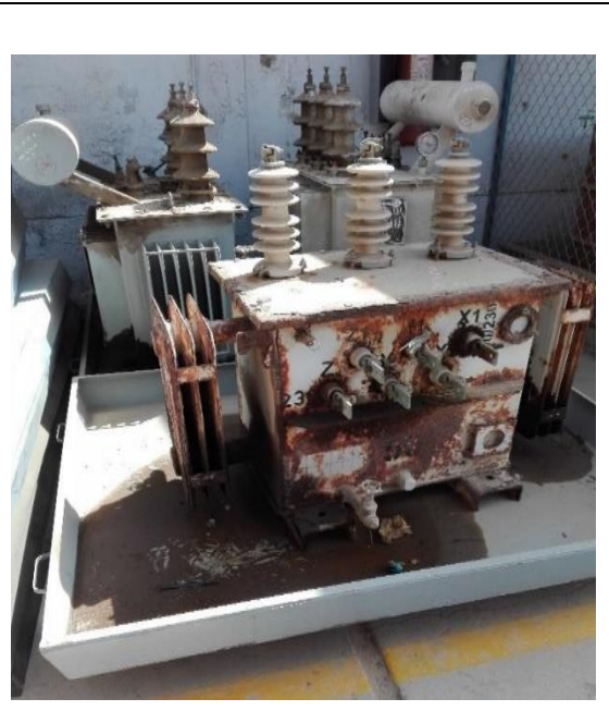
Figura 2: Transformadores en condición de mantenimiento
