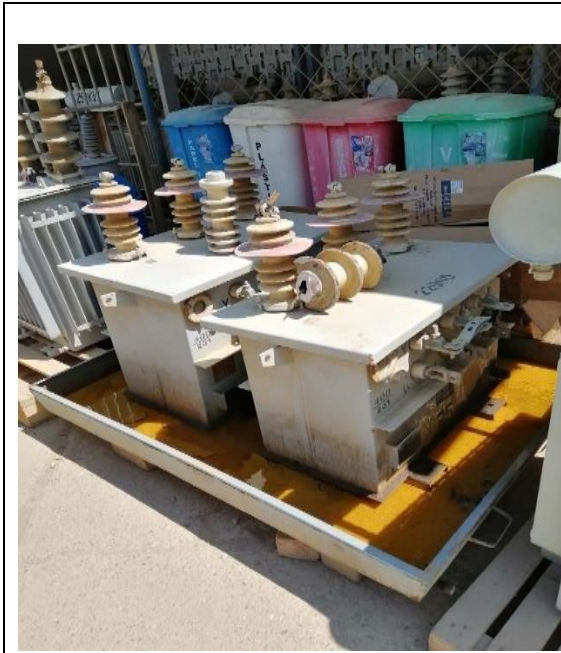
Figura 1: Transformadores en condición de mantenimiento
