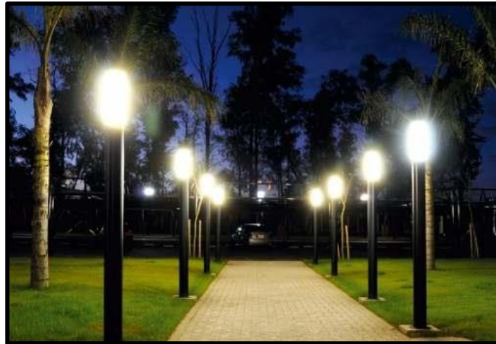
Figura 6 Iluminación en parques públicos.
