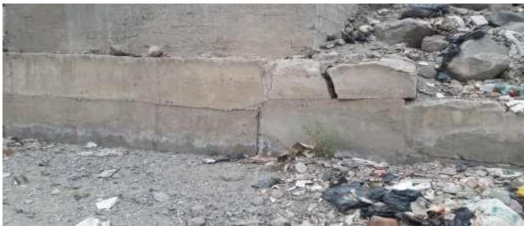
Figura 1-1: Estado actual de muros en la cabrada seca QUIRIO
