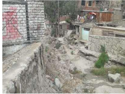
Figura 17. Cimiento del muro de contención expuesto por paso de huayco.
