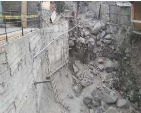
Figura 15. Erosión que a sufrido el cauce del huayco
