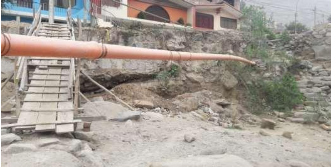
Figura 1-3: Efecto de los flujos de lodos en las estructuras.
