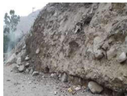
Figura 12. Muro natural socavado
