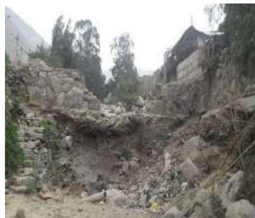
Figura 18. Dique destruido por paso de huayco.
