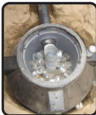
Figura 1-13 – Los aros de plástico en el interior del Biodigestor funcionan como filtro
