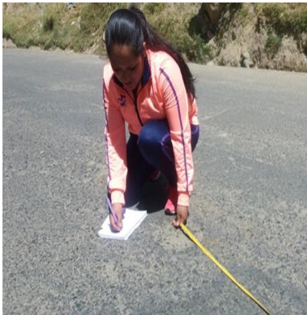
Figura N°08. Medición de la patología de pulimiento de agregados
