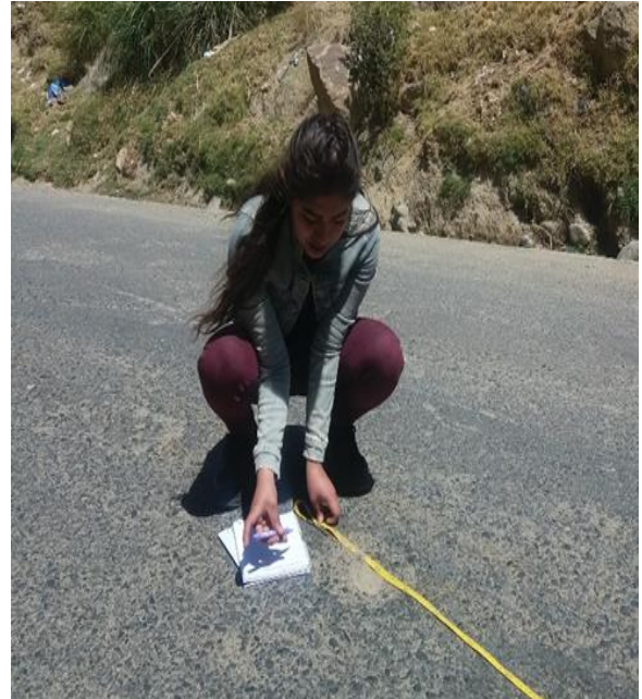
Figura N°09. Medición de la Patología de huecos y hundimiento
