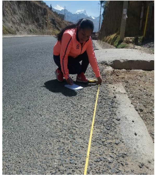
Figura N°07. Patología de desprendimiento de agregado
