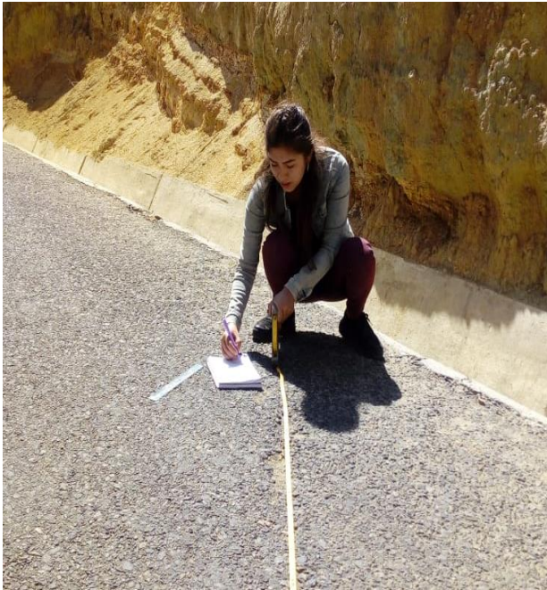
Figura N°06. Se observa la patología de bache de borde en el pavimento flexible
