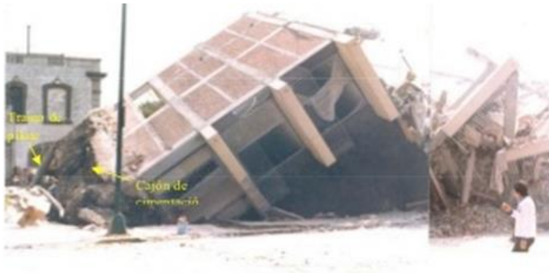
Colapso total por volteo de un edificio cimentado con cajón y pilotes de fricción. Sismo de Michoacán, Septiembre 19 de 1985.
