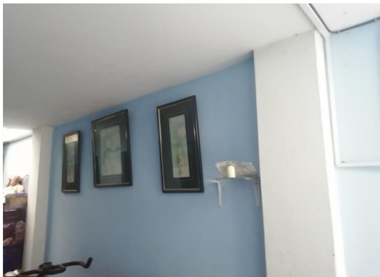
Foto 2. Las columnas son de la misma dimensión del primer piso, pero, en el segundo nivel es muro de soga y no de cabeza.
