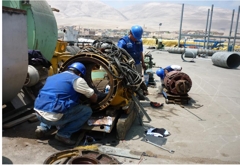
Figura 48. Limpieza de estator y alineamiento de rotor de separador industrial.
