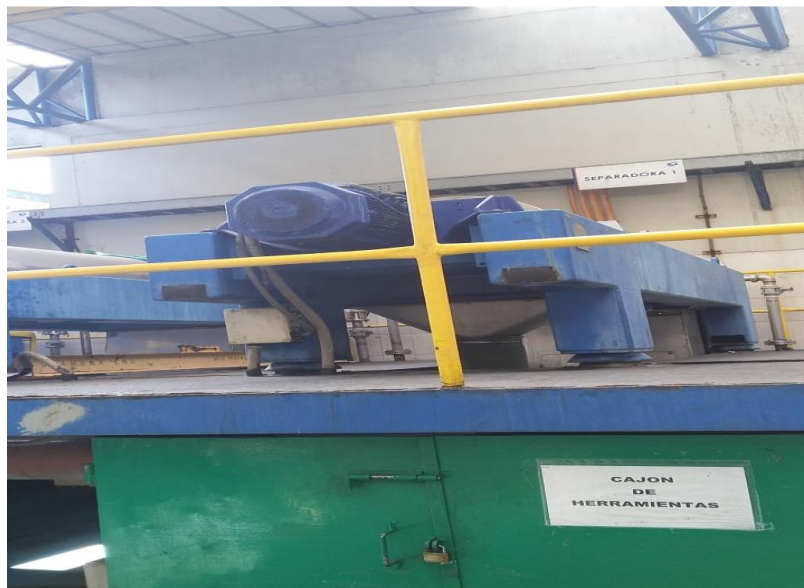
Figura 51. Motor principal de separador de sólidos.
