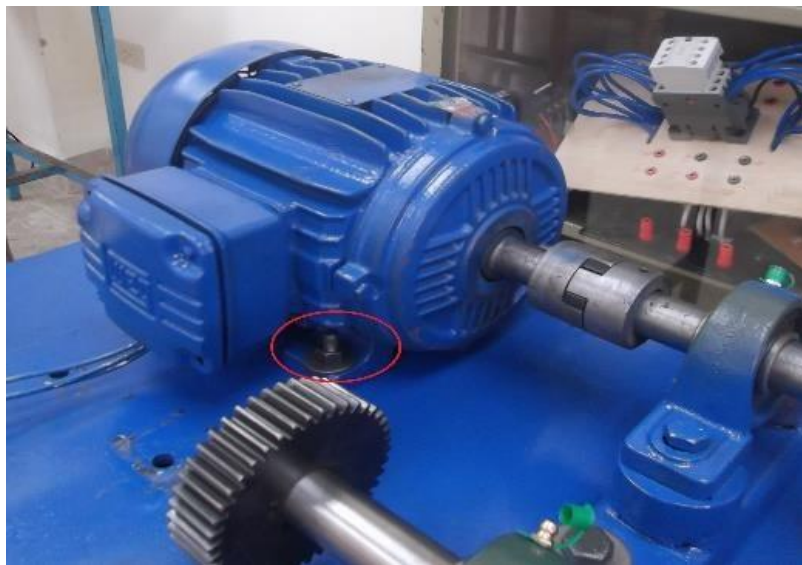
Figura 55. Nivelación de motor de transmisión, acoplado a chumaceras, debido a sobreesfuerzo del motor de la cocedora de pedestal.
