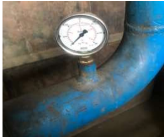
Figura 11. Medición de presión Fuente: Elaboración propia
