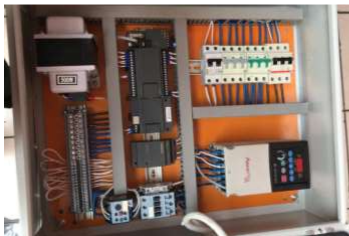
Figura 50. Tablero de control culminado Fuente: Elaboración propia
