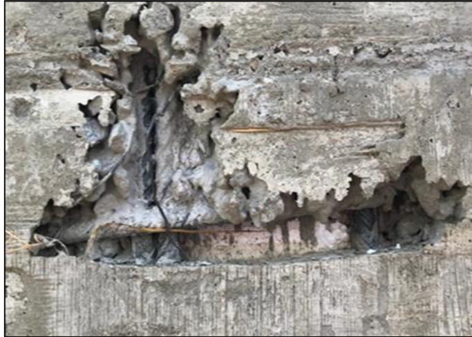
Figura 8. Cangrejas en concreto.
