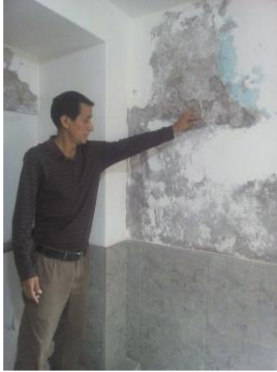
Imagen No. 14: Viviendas afectadas.
