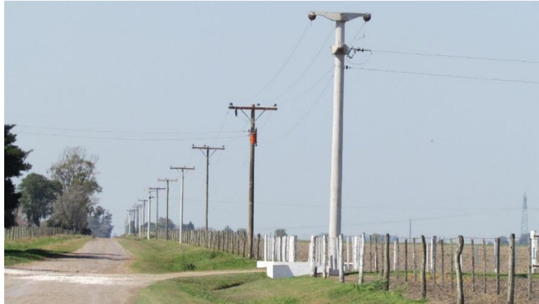
Figura 2. Distribución en media tensión.
