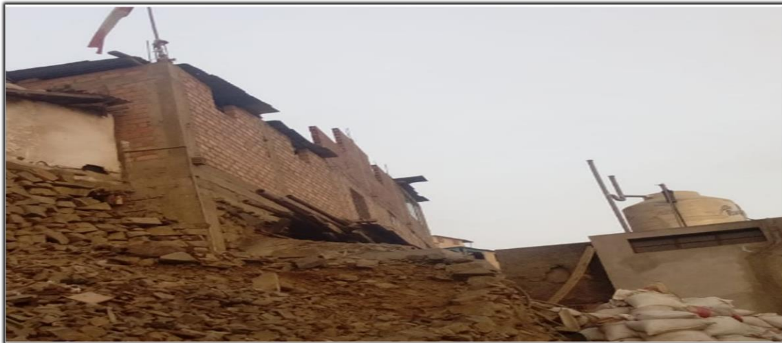
Figura 3. Edificación sin cimentación adecuada
