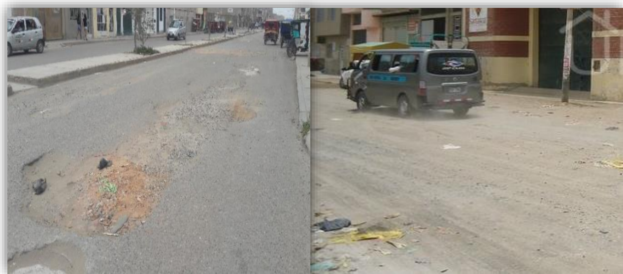
Figura 2. Deterioro, Av. Mariano Cornejo. Cuadra 02 y 06 respectivamente
