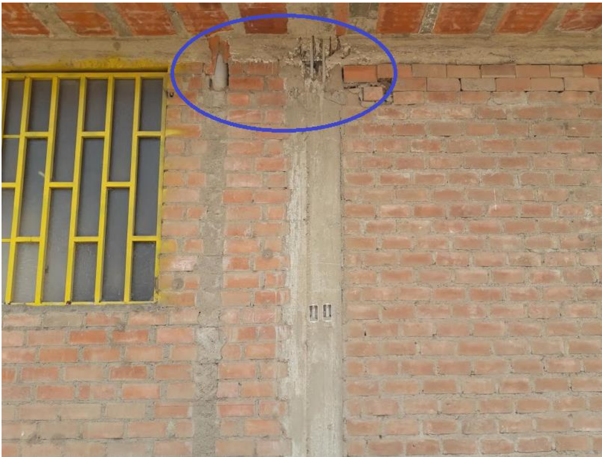
Figura 9: Vivienda con aceros expuestos y con corrosión
