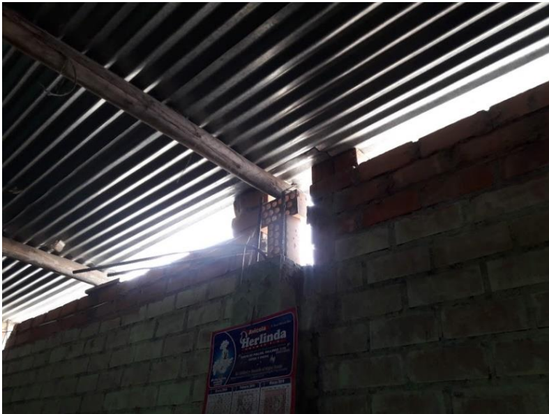
Figura 12: Tipo de cubierta y fijación inestable con el muro
