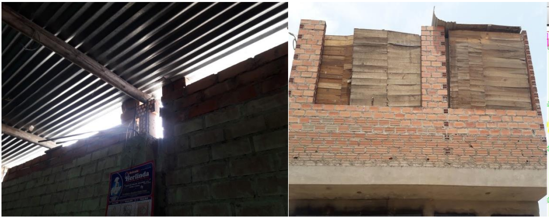
Figura 13: Elementos no estructurales, como los parapetos sin conexión
