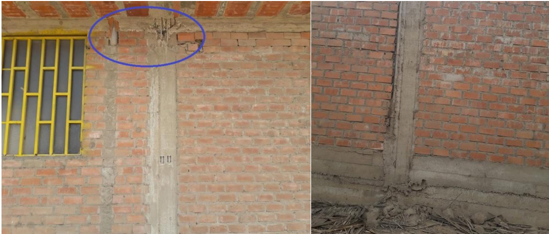
Figura 14: Estado de conservación inaceptable
