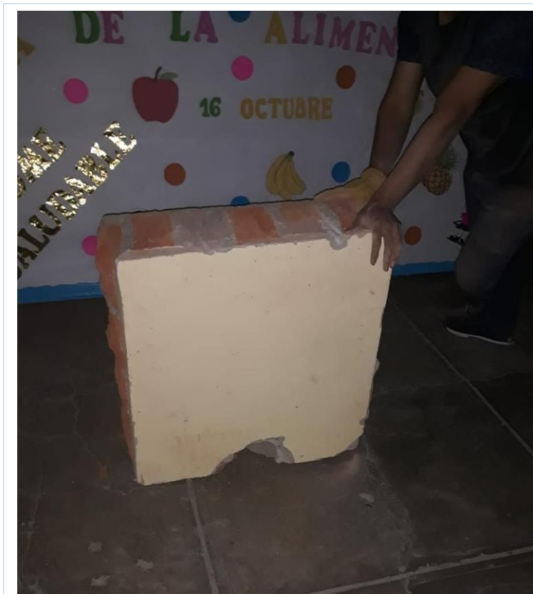
Extracción de murete de pabellón "A" de la IE 20825 – Túpac Amaru II
