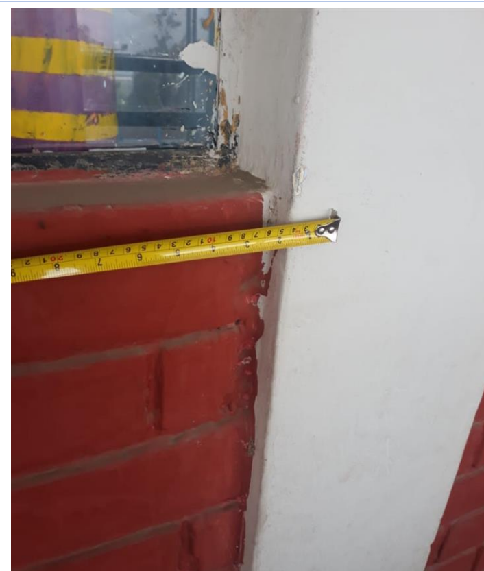
Auscultación de la junta entre la columna y muro de albañilería.
