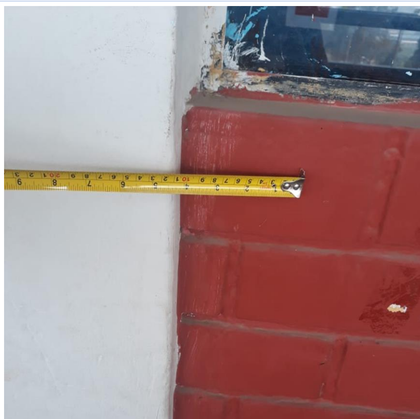
Auscultación de la junta entre la columna y muro de albañilería.
