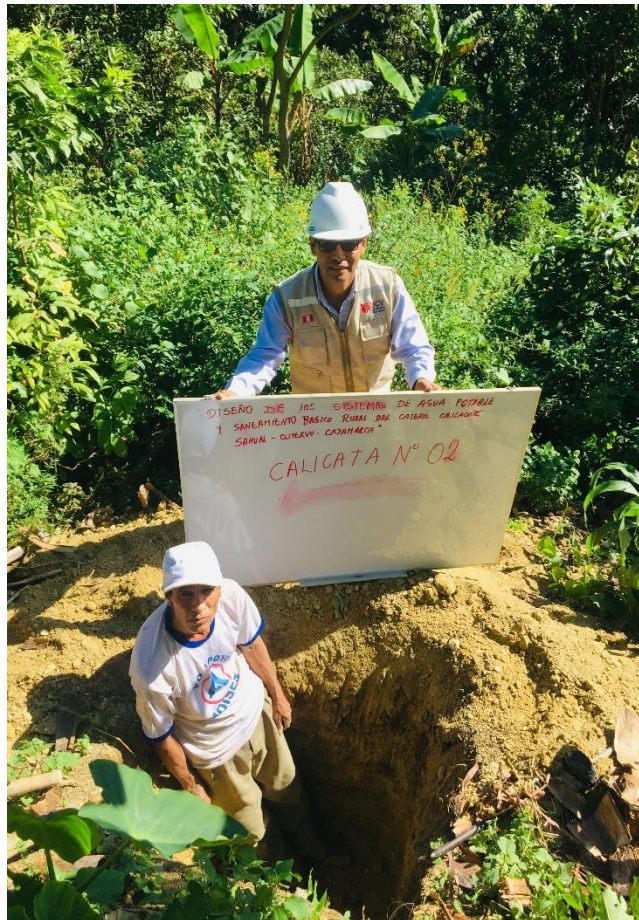
Foto 02: Toma de muestra Calicata N° 02
