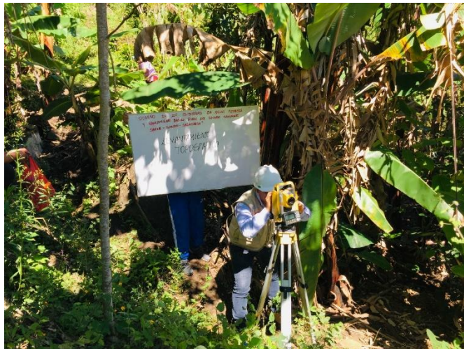
Foto 02: Se observa uso de la Estación Total para la obtención de los datos topográficos.
