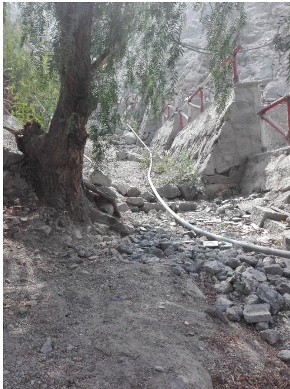
Figura 27. Vegetación existente en el relleno del muro de contención
