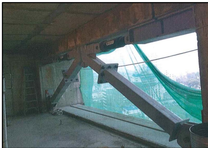
Figura 64. Disipador y estructura metálica instalados
