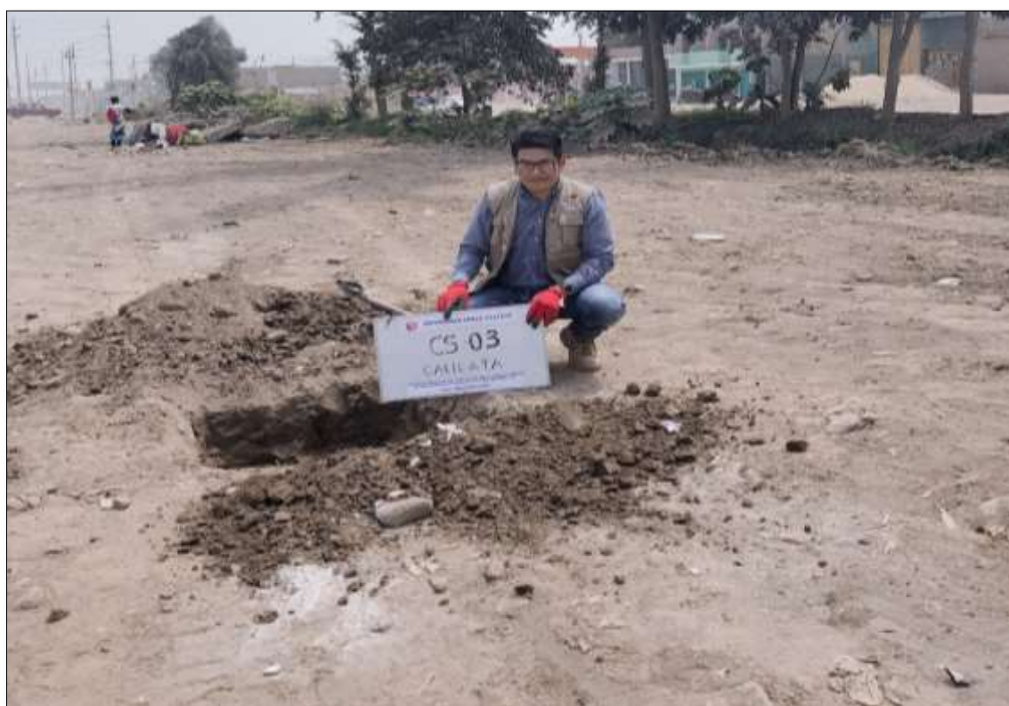
Imagen 14: Ubicación de las calicatas CS-03 en la progresiva 25 + 500 para la toma de muestra de suelo a 1.5 m de profundidad.
