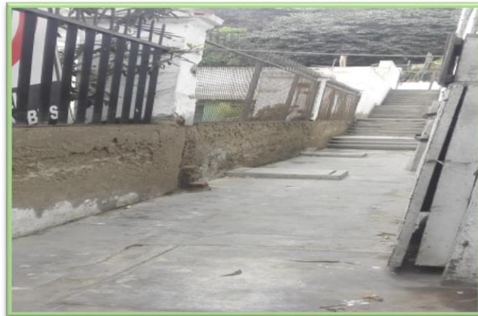
Figura 5. Ataques químicos al concreto
