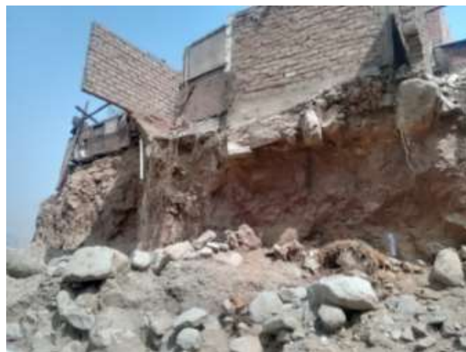
Figura 2: Vivienda afectada por la inundación en la zona del Pedregal Fuente: Elaboración Propia
