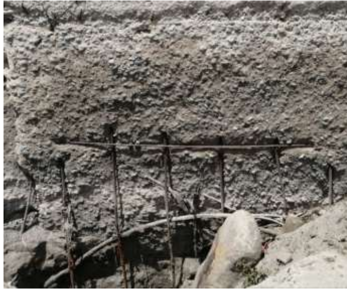
Figura 3: Estado actual del muro de defensa ribereña Fuente: Elaboración Propia
