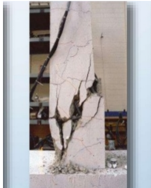
Figura 1.18. Falla por cortante en parte inferior de la columna
