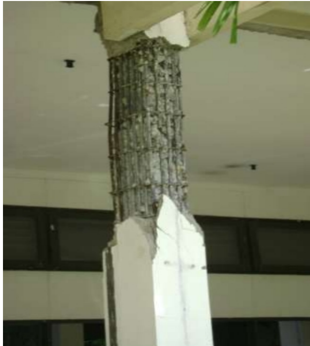
Figura 1.15. Falla por adherencia en columna
