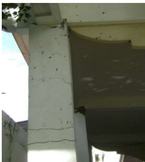
Figura 1.14. Falla por flexión en columna
