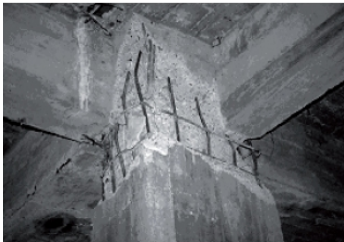
Figura 1.16. Falla por adherencia en columna-viga
