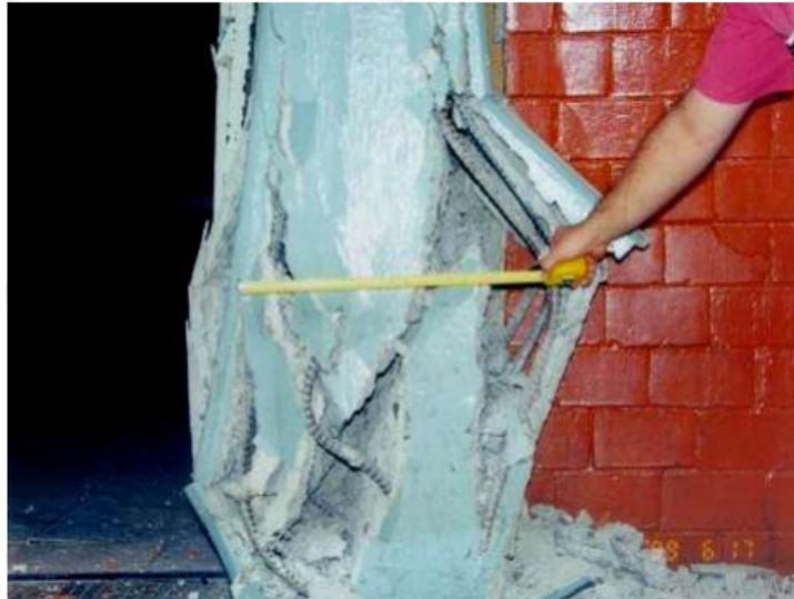
Figura 1.13. Falla por compresión en columna
