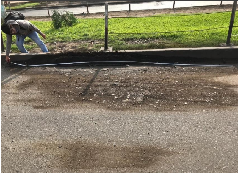
Figura 41: Agregado Pulido en el Pavimento
