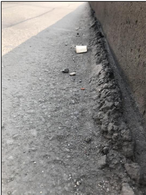
Figura 36: Abultamiento en el Pavimento
