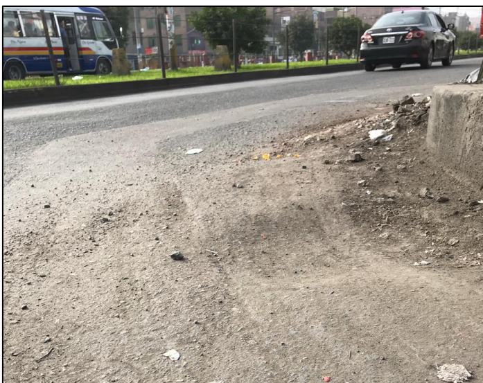
Figura 40: Ahuellamiento en el Pavimento
