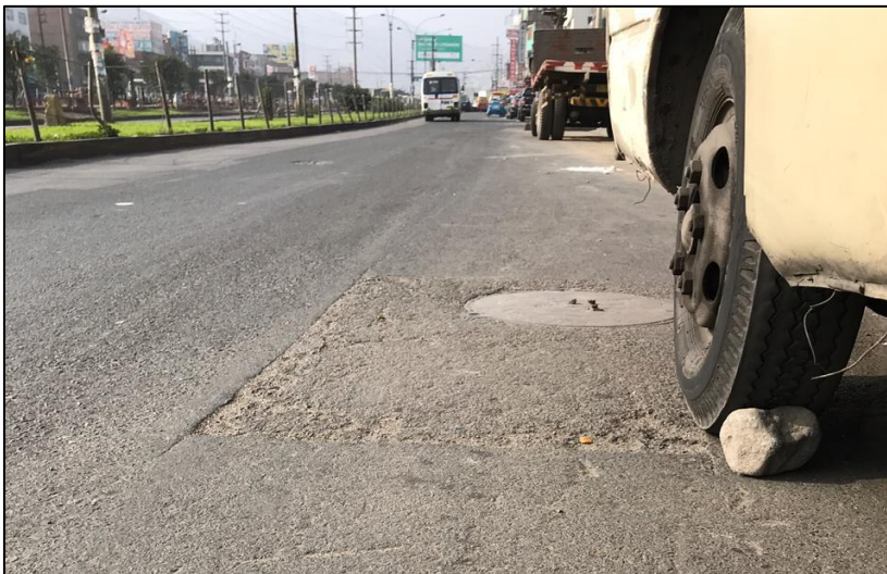
Figura 42: Agrietamiento en Bloque en el Pavimento
