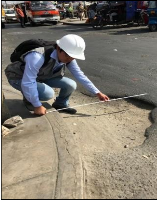
Figura 35: Baches en el Pavimento
