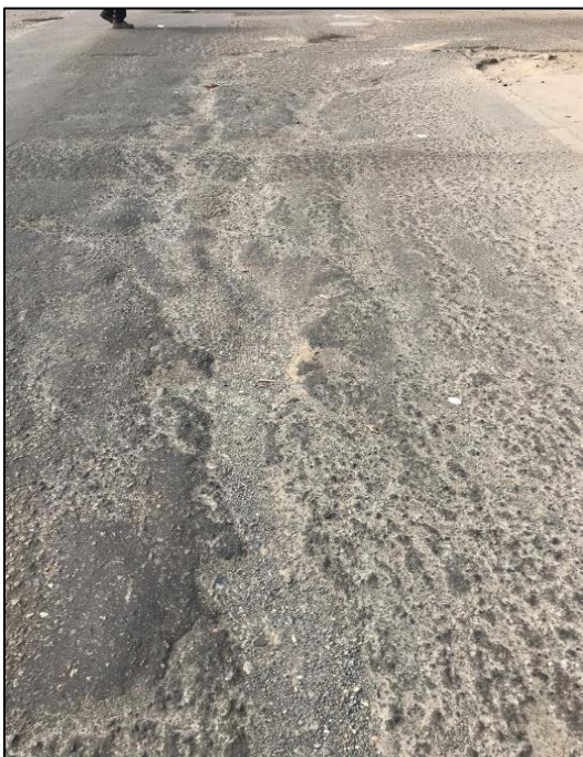
Figura 38: Grieta Longitudinal en el Pavimento
