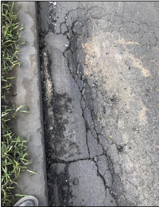
Figura 37: Grieta de Borde en el Pavimento
