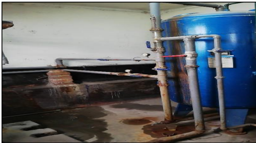
Figura 1. Las tuberías de agua en el cuarto de máquinas han colapsado por la antigüedad de las instalaciones
