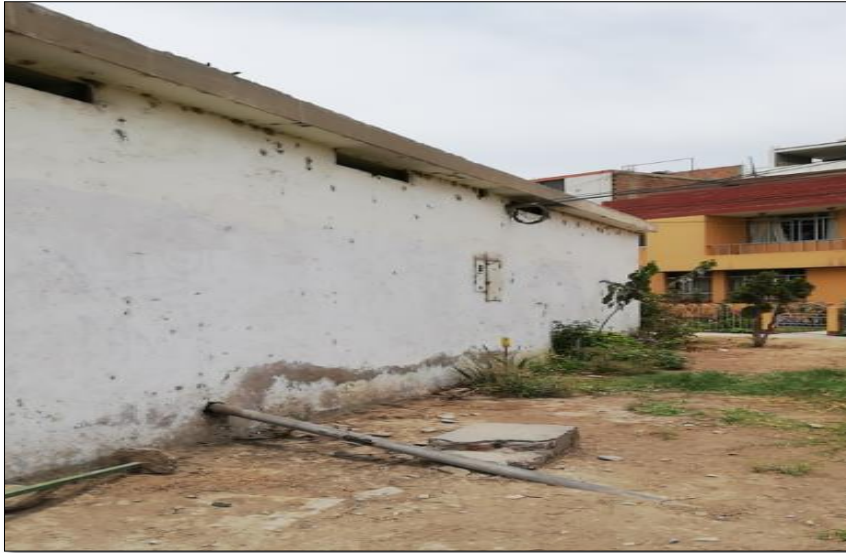
Figura 2. Fuente de abastecimiento pozo Subterráneo la tubería de impulsión está expuesta a posibles roturas
