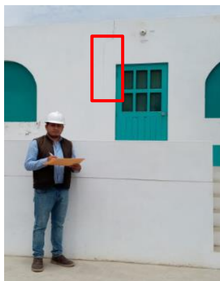
Figura 12. Fisuras en las viviendas. Fuente: Elaboración propia.
