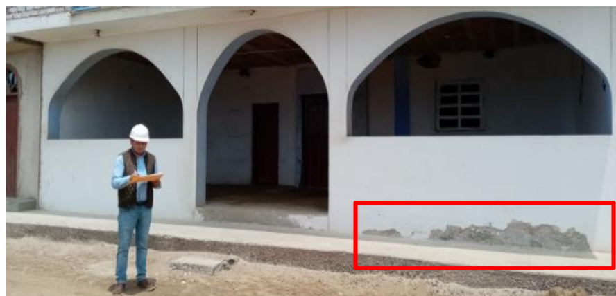
Figura 10. Humedad en las viviendas. Fuente: Elaboración propia.
