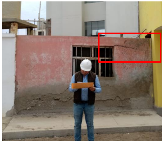
Figura 11. Grietas en las viviendas. Fuente: Elaboración propia.
