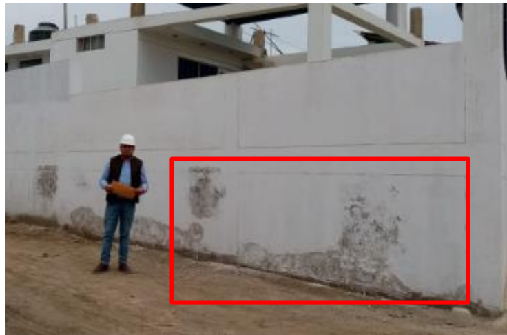
Figura 9. Humedad en las viviendas. Fuente: Elaboración propia.
